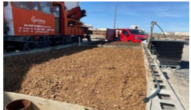
Tecnología de descontaminación en suelos a escala real en las instalaciones de ACCIONA
